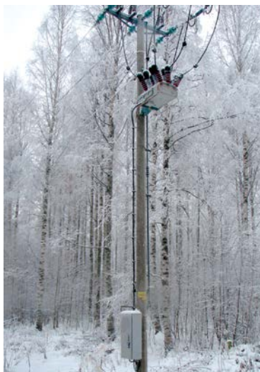
RECONECTOR OSM Y CUBÍCULO DE CONTROL Y COMUNICACIONES RC
